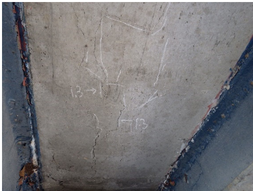
コンクリート床版の浮き (修繕済)
