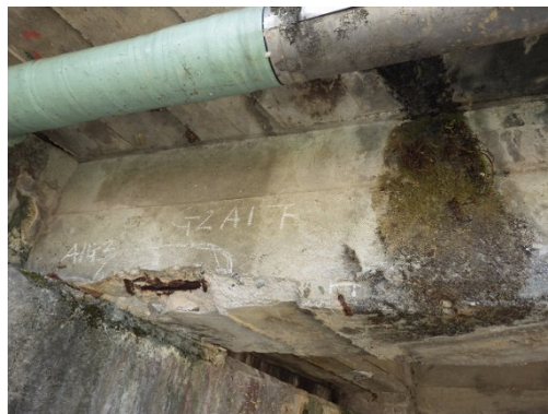
コンクリートのはく離・鉄筋露出
