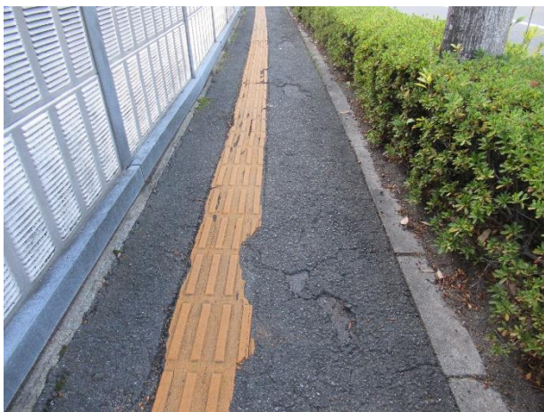
歩道部のひび割れ
