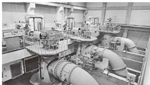
府中ポンプ場内部（くすのきプラザ向かい側のポンプ場）直径135cmのポンプが3台あり、3台同時に運転すると、1分間で687.6トンの雨水をくみ上げることができます。（昭和59年4月に2台、平成18年4月に3台目（写真奥）を供用開始）
