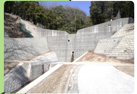
砂防堰堤(みくまり一丁目)
