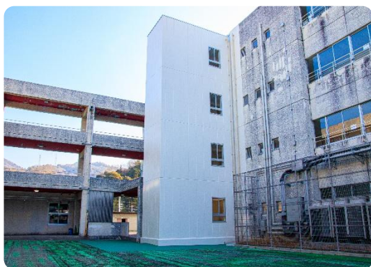
エレベーター(府中東小学校)
