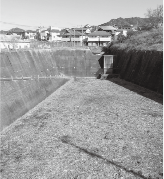
雨水を調整し、浸水を防ぐ調整池
