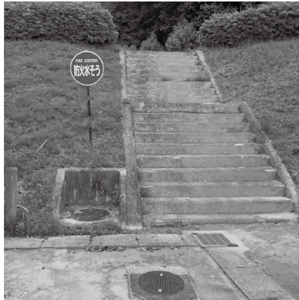
火災時の水源となる防火水槽
