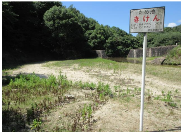
令和6年8月 撮影（現在の状態） 現在は被災直後の状態に戻っています。
