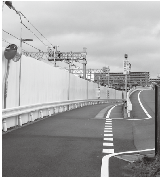
仮線沿いの道路に設置された車両検知システム
