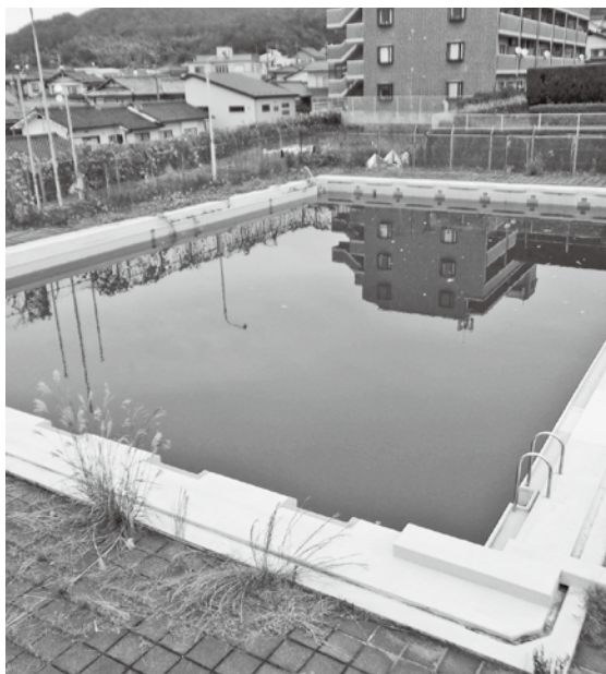
老朽化により使用中止した府中中プール
