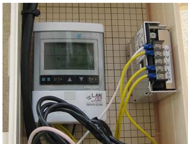
デマンド監視装置（緑ヶ丘中学校）
