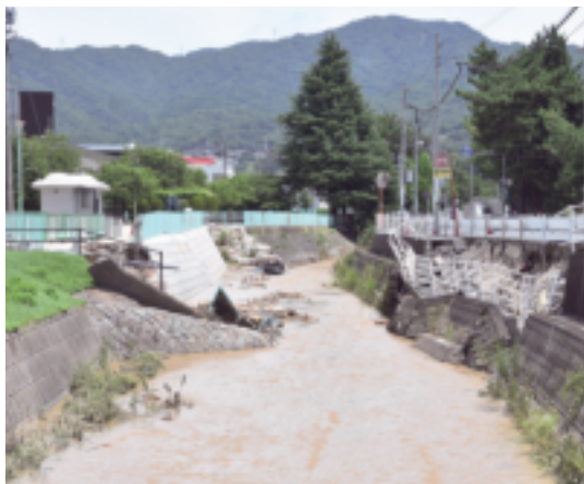
護岸の損壊(役場前)
