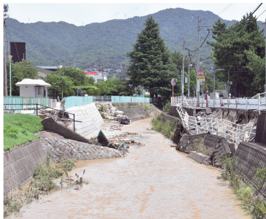
護岸の損壊(役場前)
