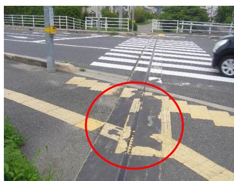
ブロックが剥れている状態
