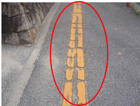
欠損が発生している状態
