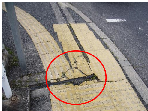
ひび割れが発生している状態
