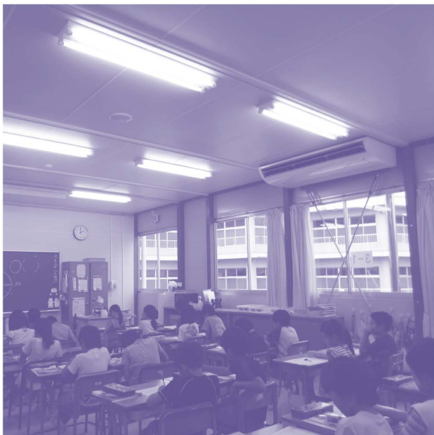
中央小仮設校舎のエアコン
