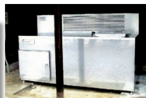
導入した生ごみ処理設備 （府中東小）
