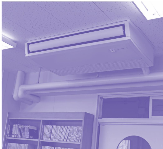
図書室のエアコン
